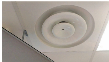
L'un des souffleurs installés au plafond du restaurant scolaire
